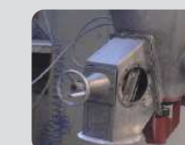
Válvula de descarga manual
