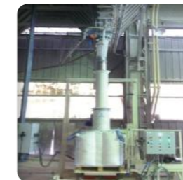
➤ Conexión bajo manga de carga de camión
