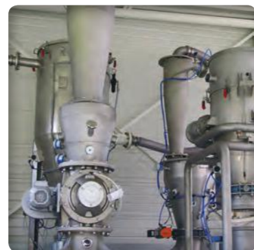
▶ Bajo ciclofiltro, transporte de resina
